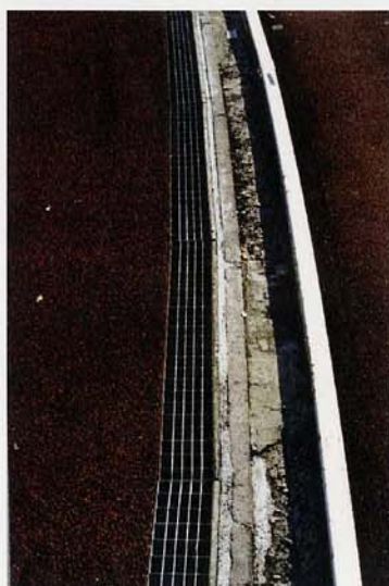
Schäden am Innenrand der Laufbahn.
