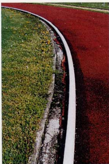
Schäden am Kunststoffbelag (Innenrand).
