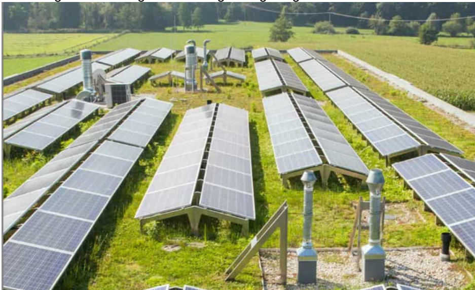
Abbildung 21: PV-Anlage in Dachbegrünung integriert
